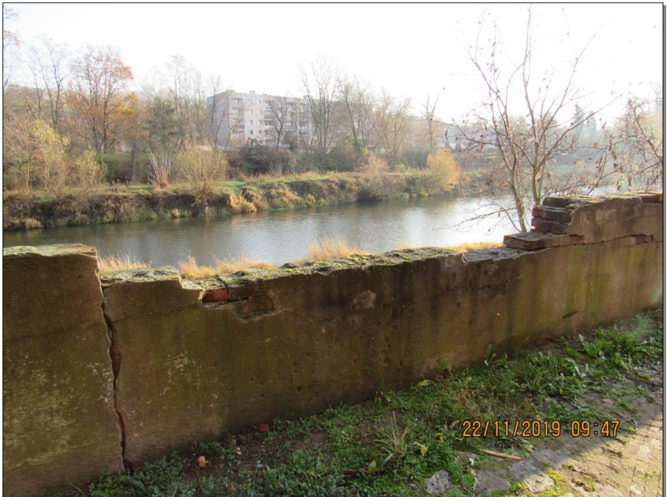
Abbildung 1- beschädigte und einsturzgefährdete Hochwasserschutzwand im Teilobjekt 3
